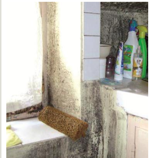
Exemple de rupture de pont thermique, Var.
